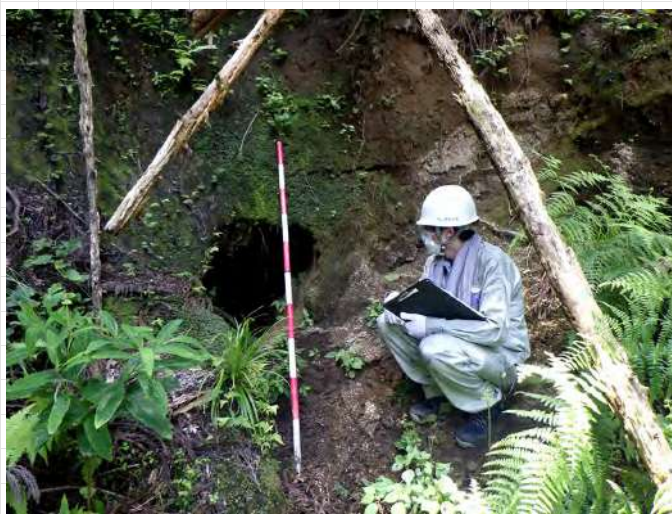
土石流が発生した溪流の崩壊箇所。地表面から数mの地中に直径50cm程度の横穴を発見。中はきれいな地層が露出し、地下水の通り道であったことから、崩壊原因と判断した。
