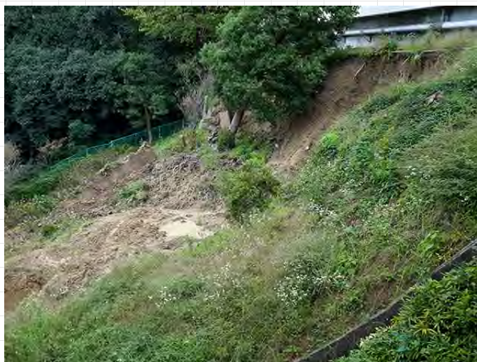
斜面崩壊した現場。崩壊直後の写真。建物の直下が崩壊し土砂が流出した。毎日学生が写真を撮影し、現地の状況をつぶさに観察した一枚。
